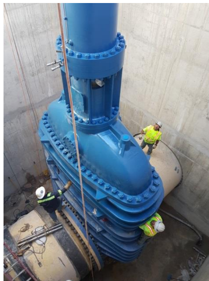
Вес задвижки составляет 100 тонн, высота - 12 метров.
