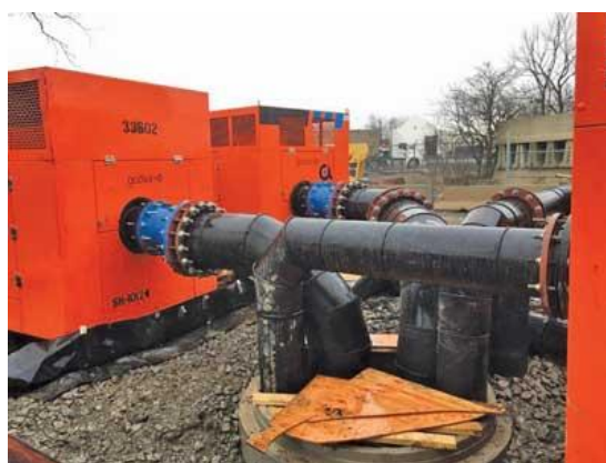
Компания «Clean Water Works» построила новый 6-футовый в глубину колодец, чтобы разместить точку всасывания насосов байпаса Godwin.
