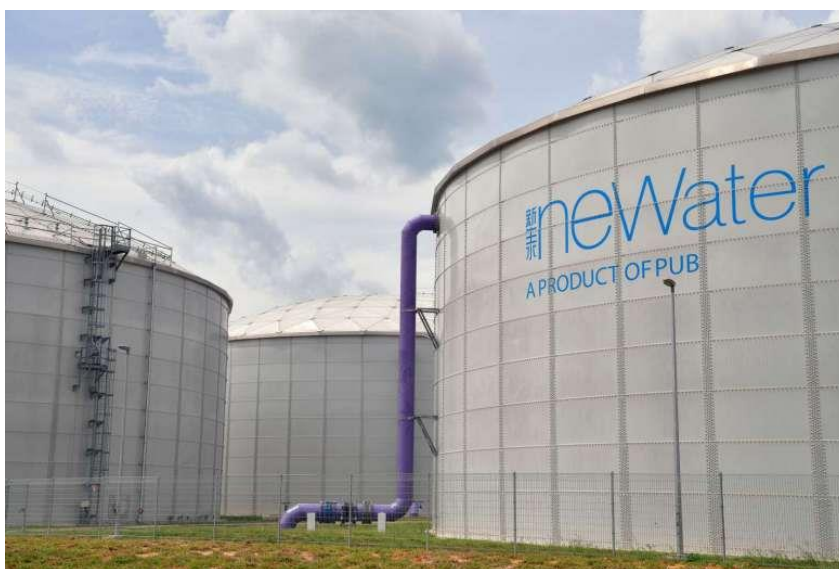
Резервуары «Newater» на новой станции в Чанги
